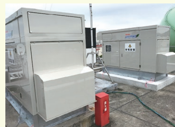
非常用発電機
