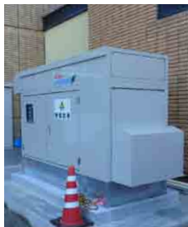
LPガス非常用発電機
