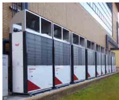
GHP（ガスヒートポンプエアコン）
