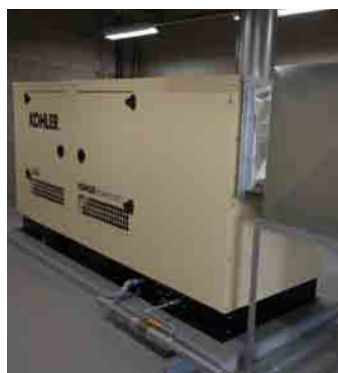
LPガス非常用発電機
