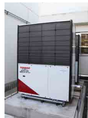
GHP(ガスヒートポンプエアコン)
