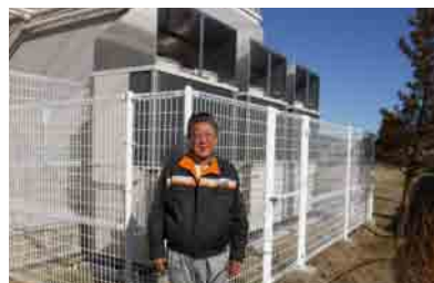
上西協議会長 GHP（ガスヒートポンプエアコン）
