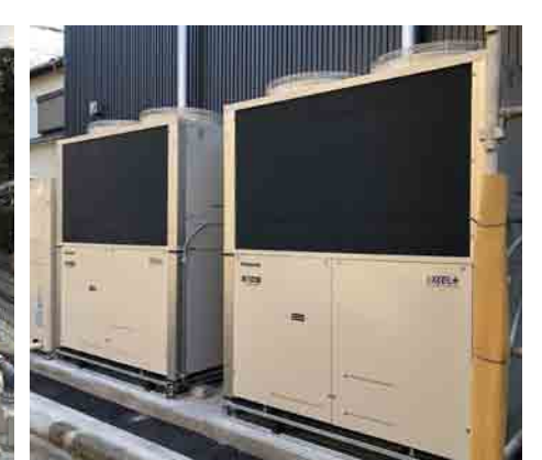
GHP(ガスヒートポンプエアコン)
