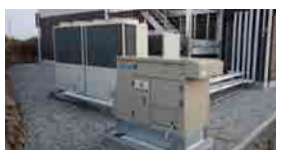
LPガス非常用発電機・GHP（ガスヒートポンプエアコン）
