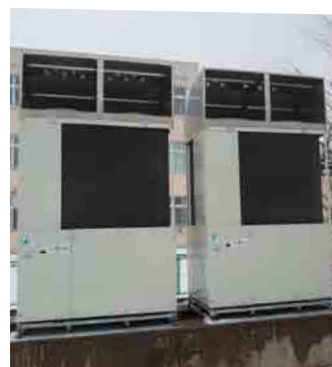
GHP(ガスヒートポンプエアコン)
