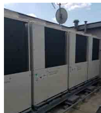
GHP（ガスヒートポンプエアコン）
