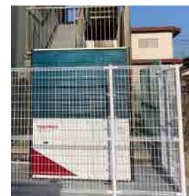
GHP（ガスヒートポンプエアコン）
