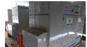
LPガス非常用発電機
