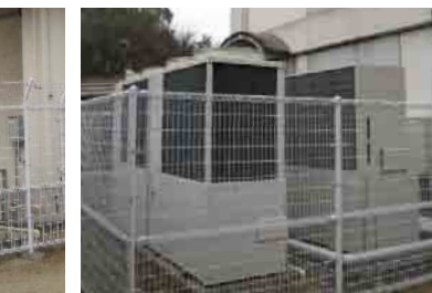
GHP（ガスヒートポンプエアコン）
