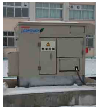
LPガス非常用発電機
