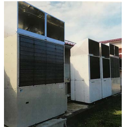
GHP（ガスヒートポンプエアコン）
