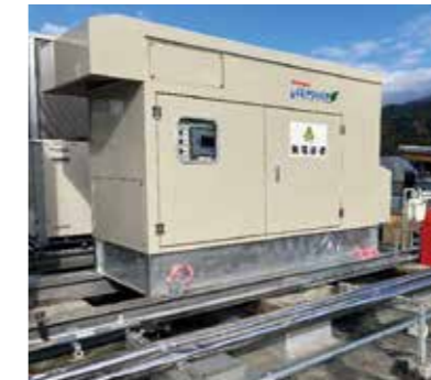
非常用発電機
