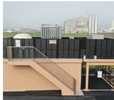
バルク貯槽と発電機は水害に備えかさ上げ設置した
