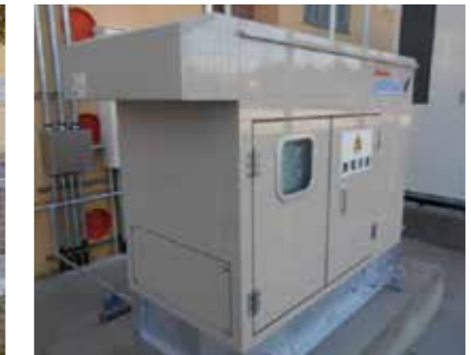
非常用発電機
