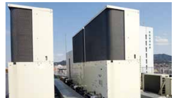
屋上に設置したGHP
