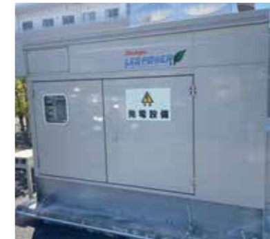
非常用発電機
