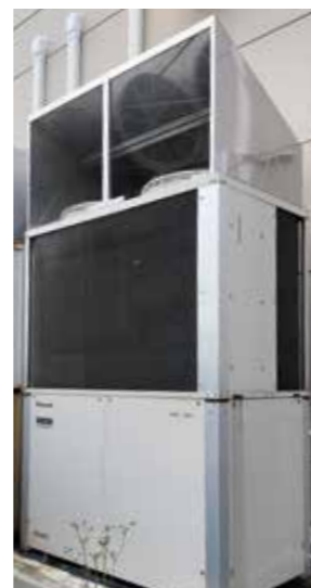
防雪フードがついたGHP室外機
