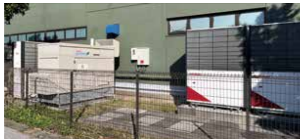
GHP室外機と非常用発電機
