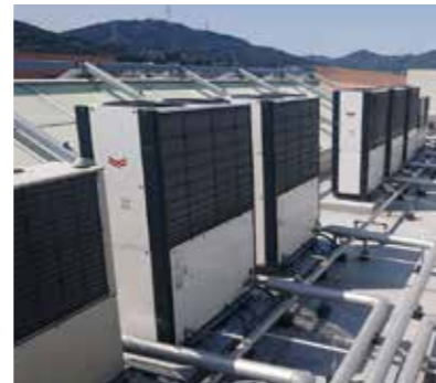
屋上に設置したGHP
