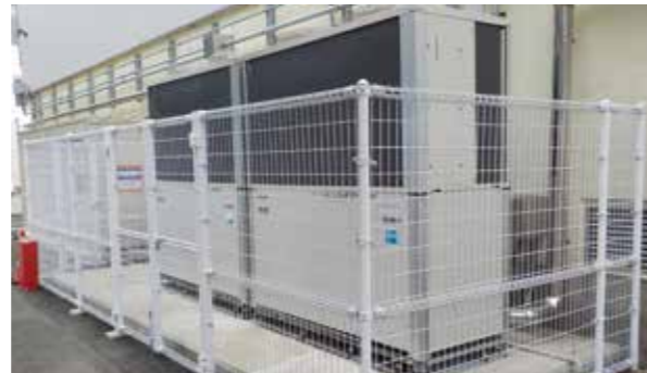
自立発電機能付きGHP室外機(高野小学校)
