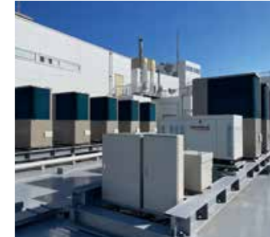
屋上に設置したGHPと非常用発電機
