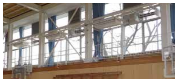
体育館内のGHP室内機(大野小学校)
