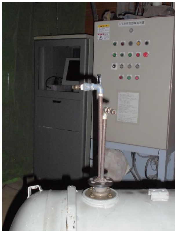
写真9 注水、排水、乾燥装置
